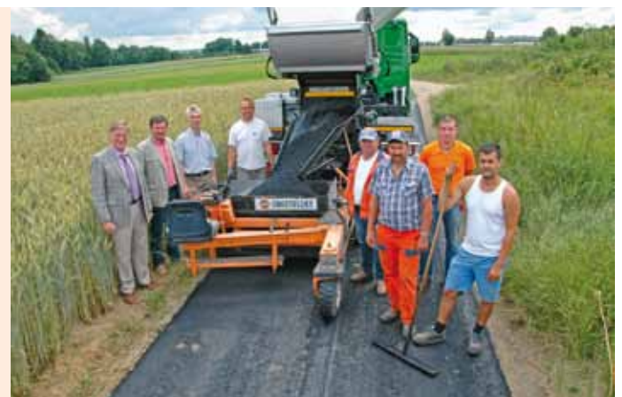
Asphaltanierung zwischen der KG Oberhof und dem Fernheizwerk Zwettl: Bürgermeister Herbert Prinz, Stadtrat Erwin Engelmayr und Baudirektor Ing. Oswin Kammerer (v. li.) dankten der „Schwarzpartie“ und begutachteten den speziellen Asphaltfertiger, der bei der Fahrspur-Sanierung zum Einsatz kam.
