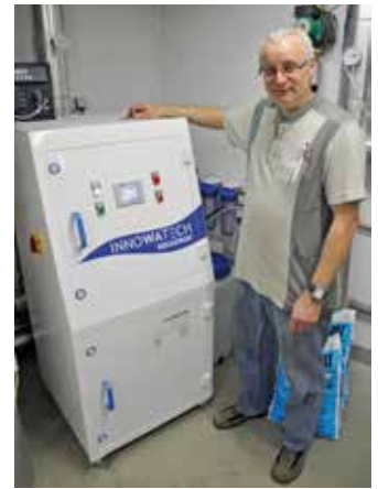
Die neue Wasseraufbereitungsanlage wird von Haus-techniker Franz Kurz betreut.
