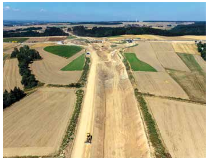
Erbbauarbeiten auf der B 38 Haupttrasse und linksseitigen L 8230 „Spange Dürnhof“ in Blickrichtung Anschlussstelle „Zwettl Nord“ mit der kreuzenden B 36 und Kreisverkehr (Blickrichtung Westen) und Talübergang über den Gradnitzbach im Hintergrund
