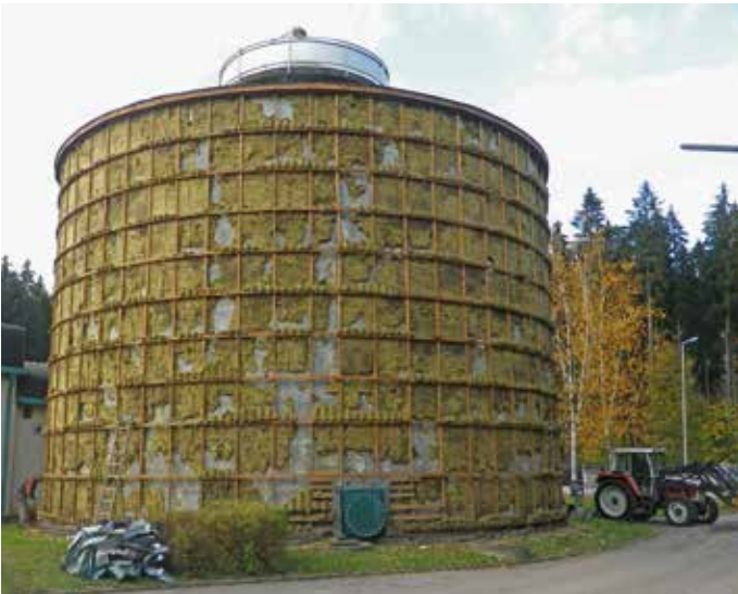
So stellte sich der Faulturm zu Beginn der Sanierungsarbeiten dar – fehlende bzw. von Mardern zerfressene Dämmung.
