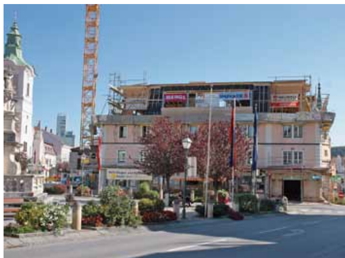
Der Umbau des Wohn- und Geschäftsgebäudes am Zwettler Sparkassenplatz schreitet zügig voran, hier eine am 3. Oktober aufgenommene Gesamtansicht.
