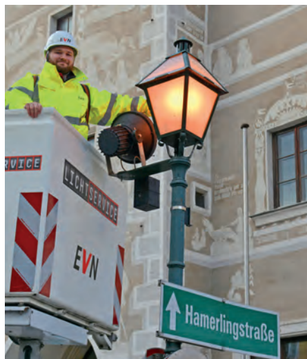
EVN-Mitarbeiter Martin Barkoczi prüft aktuell die öffentliche Beleuchtung in der Stadtgemeinde Zwettl, wie etwa hier vor dem Alten Rathaus.
