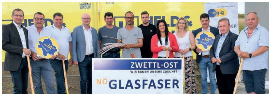
Feierten mit einem Spatenstich den Baustart für das Glasfasernetz in Zwettl-Ost: Stadtrat Ing. Gerald Gaishofer, Gemeinderat Günther Edlmaier, Ortsvorsteher Andreas Lintner, Ing. Martin Steindl (Held & Francke), Ortsvorsteher Martin Weidenauer, Karl Rester (Held & Francke), Daniel Landstetter (Held & Francke), Gemeinderätin Dagmar Zinner, Ortsvorsteherin Manuela Krammer, Stadtrat Erich Stern, Bürgermeister LAbg. ÖKR Franz Mold und Ortsvorsteher Franz Zeindl-Schierhuber.
